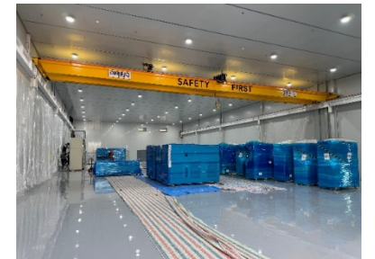
クリーンルーム
