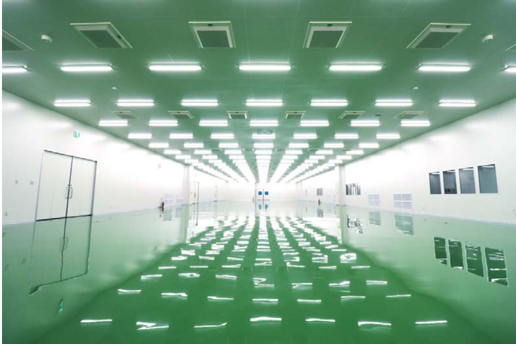
2Fクリーンルーム
