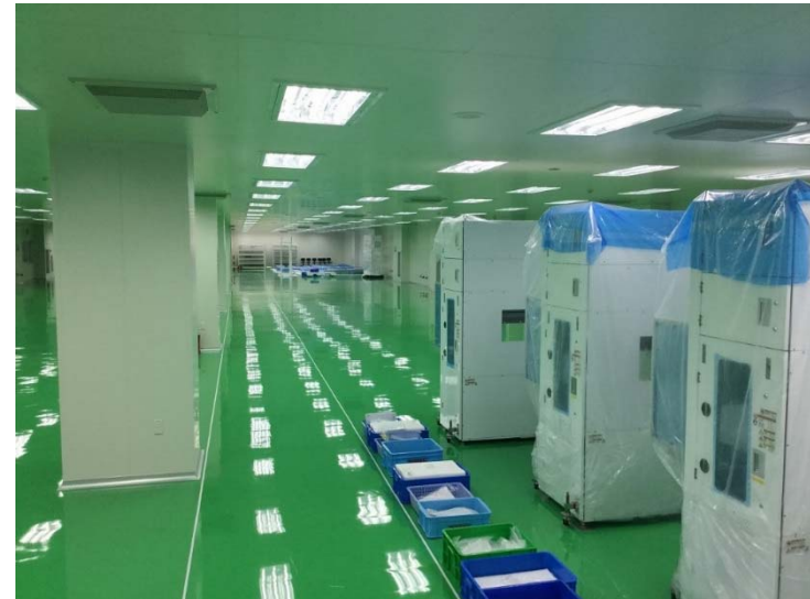
3階：クリーンルーム
